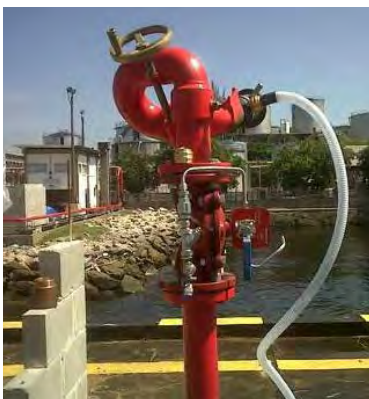
КОНТРОЛЬНЫЙ КЛАПАН ПЕННОГО ПОЖАРОТУШЕНИЯ
